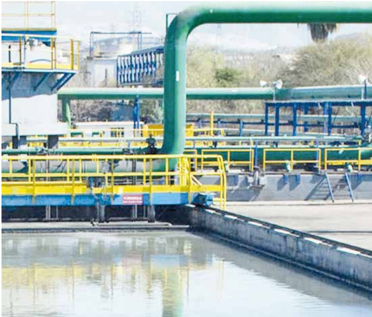
LA PLANTA TRATADORA de aguas residuales se mantiene bajo análisis para determinar su viabilidad y el aprovechamiento del agua tratada en futuros proyectos industriales.
