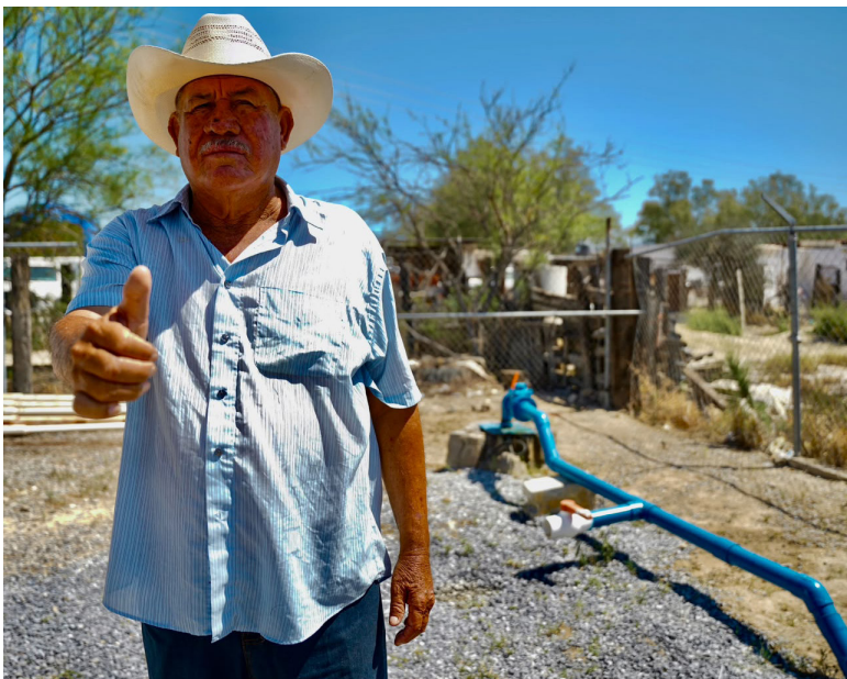
CON UNA INVERSIÓN de 246 mil pesos se instaló un nuevo sistema encabezado por una bomba sumergible de 15 caballos de fuerza.
