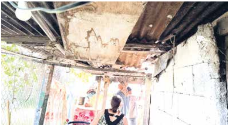
LA ESTRUCTURA DE madera deteriorada ponía en riesgo permanente a tres integrantes.
