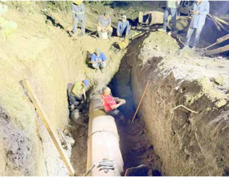
TÉCNICOS ATENDIERON UNA falla en la línea principal.
