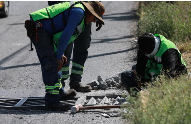
PARA ELIMINAR POSIBLES riesgos ocasionados por la rejilla pluvial deteriorada, ubicada sobre la lateral del Bulevar Fundadores.
