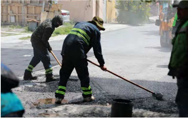
CUADRILLAS MUNICIPALES ATIENDEN tramos deteriorados en avenidas principales.
