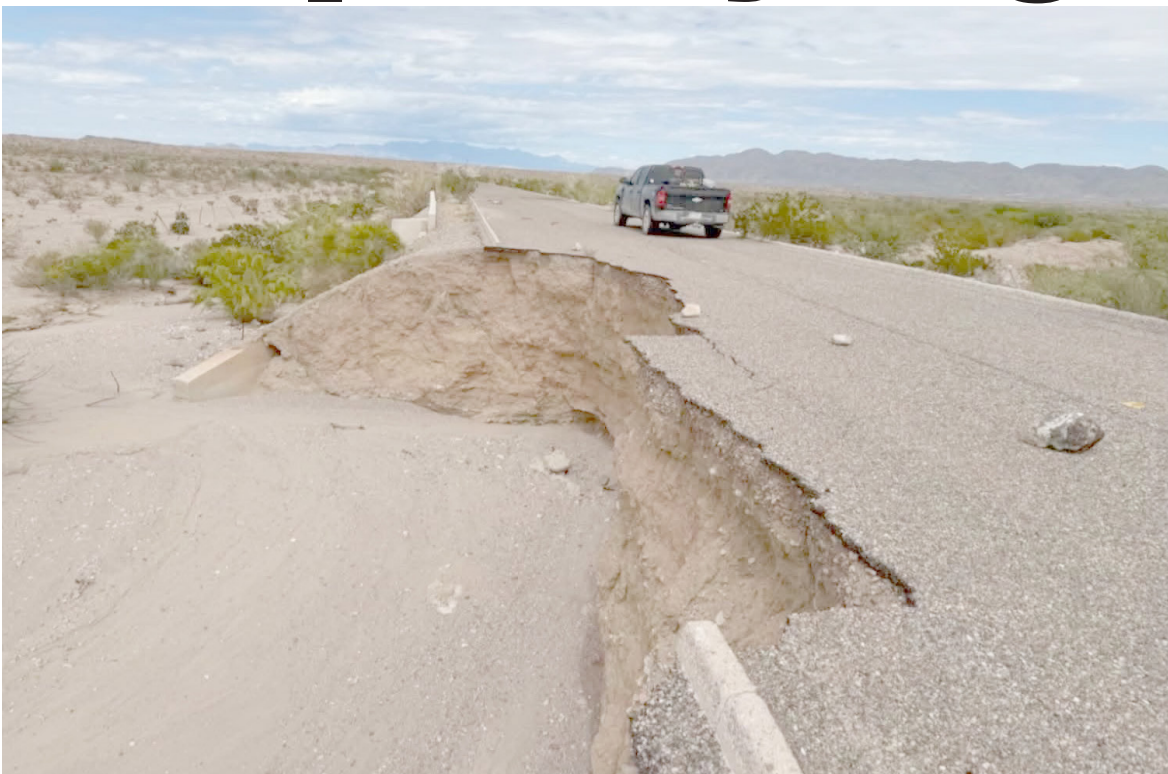
EROSIÓN DEBILITA LA carretera Múzquiz–Ojinaga en Ocampo.
