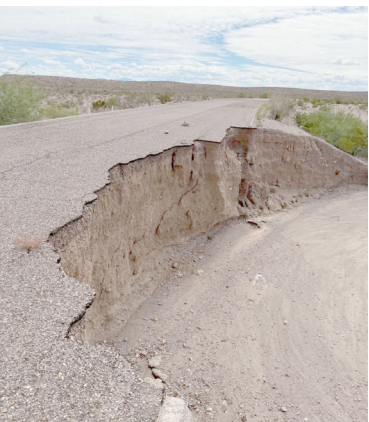
LAS IMÁGENES EXHIBEN el pavimento fracturado y el terreno debilitado.
