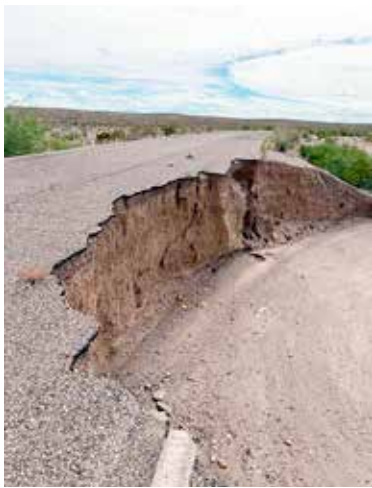
EROSIÓN DEBILITA LA carretera Múzquiz–Ojinaga en Ocampo.
