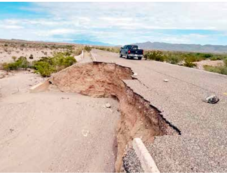
LAS IMÁGENES EXHIBEN el pavimento fracturado y el terreno debilitado.
