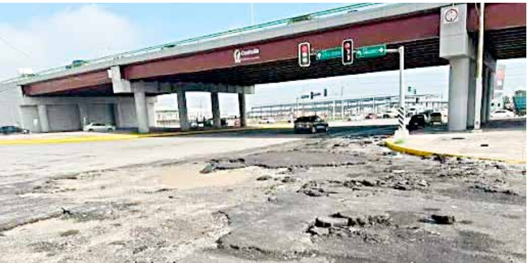
LOS BULEVARES ANTONIO Cárdenas y Periférico Luis Echeverría figuran entre las vialidades donde los escurrimientos causaron daños que no se resuelven con bacheo.
