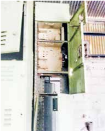
INSTALACIONES DEL POZO de bombeo ‘Fresnillo Mora’ en el ejido Fresnillo, vandalizadas y reducidas a chatarra tras el abandono industrial.
