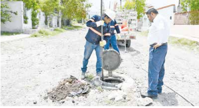
PIDEN A CIUDADANÍA evitar utilizar drenaje sanitario para desalojar agua pluvial.
